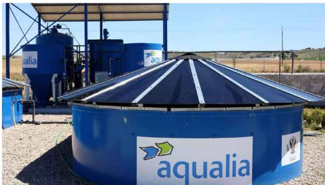
Instalaciones de Aqualia en la provincia de Toledo.
